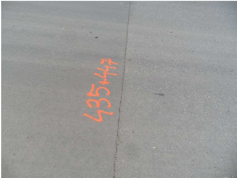
Widok pękniętej nawierzchni
